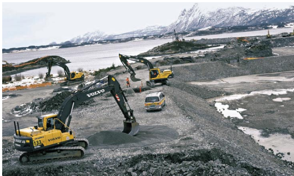
Der Energieträger Öl wird zur Mitte des 21. Jahrhunderts noch eine tragende Rolle im globalen Energiemix spielen. Langfristig werden aber Treibstoffe aus Erdgas oder Biomasse im Verkehrssektor an Wettbewerbsfähigkeit gewinnen. Im Bild eine Baustelle von Ormen Lange, zu Deutsch «lange Schlange», dem Erdgasfeld, das rund 100 km vor der norwegischen Küste unter dem Meeresboden liegt.
